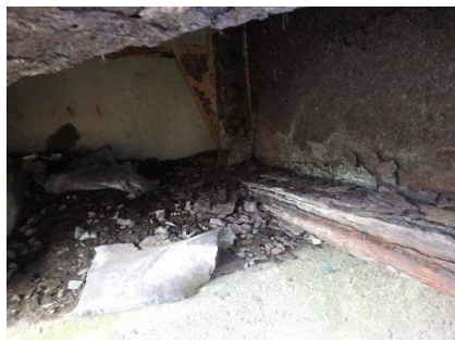
鋼橋の主桁の腐食
