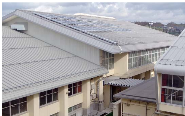
公共施設における太陽光パネルの設置
