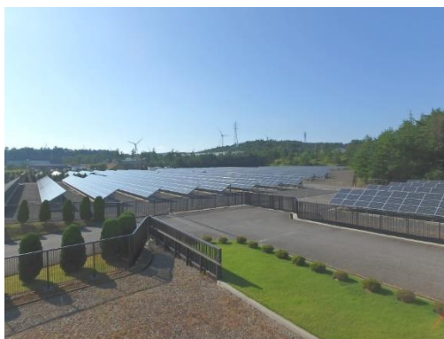
図 3-3 志賀太陽光発電所
