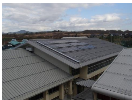
太陽光パネル
