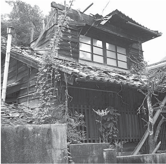
倒壊の恐れがある危険家屋（イメージ）
