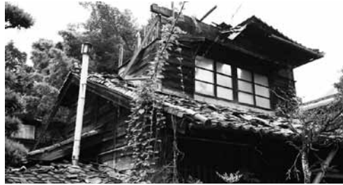
危険な空き家（イメージ）
