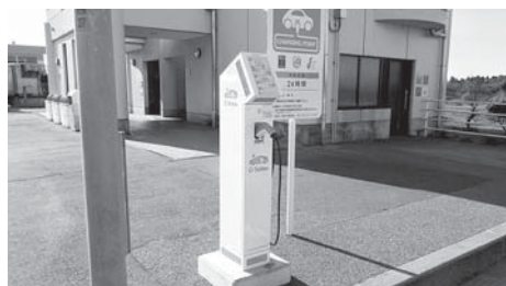
西山PAに設置された充電スタンド
