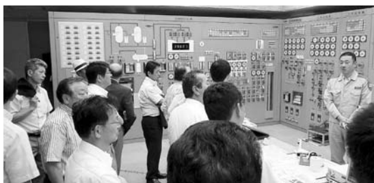
地熱発電所の中央制御室
