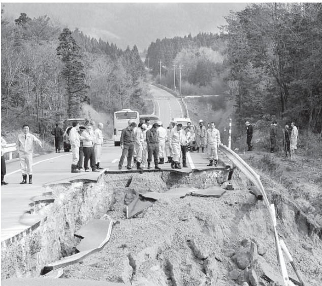
平成19年に発生した能登半島地震で崩壊した広域農道(給分地内)。災害はいつ発生するか予測できない。
