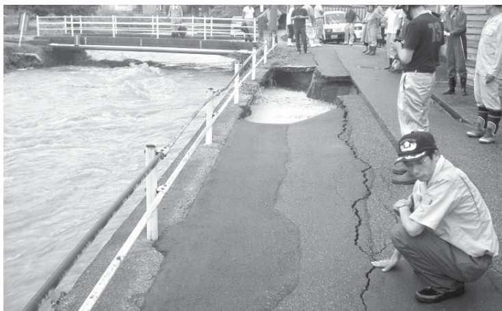
昨年7月の大雨で川の増水により崩壊した町道(酒見地内)
