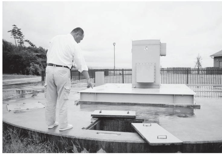
しき鳥方式(下水道汚泥を搬出しなくてよい運転方式)を休止した中央水処理センターオキシデーションディッチ
