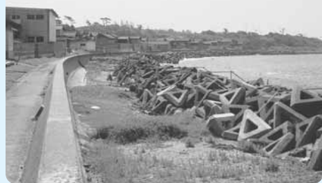
冬季風浪により被災した赤崎漁港消波堤
