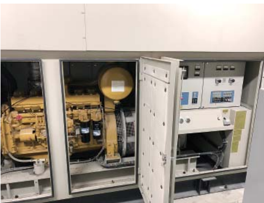
庁舎に設置の非常用電源
