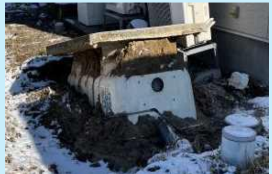
地震により浮き上がった浄化槽
