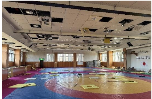
総合武道館（2階）の被災状況
