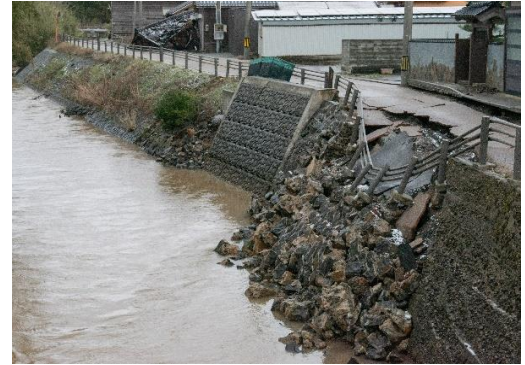
富来川の被災状況
