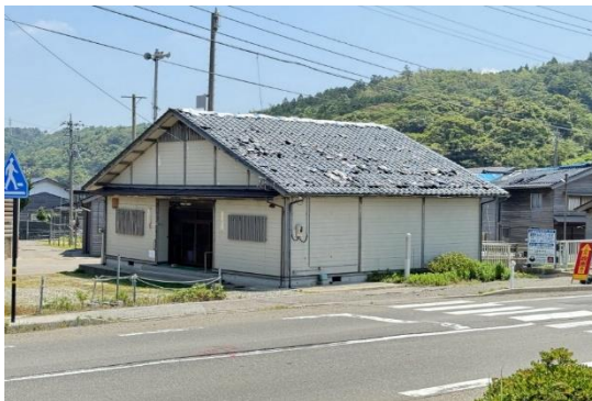
七海集会所の被災状況
