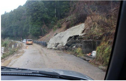
県道輪島富来線の被災状況
