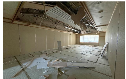
いこいの村能登半島の被災状況
