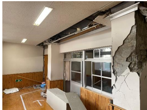
富来小学校の被災状況
