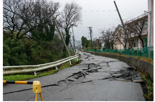
富来小学校付近の道路の被災状況
