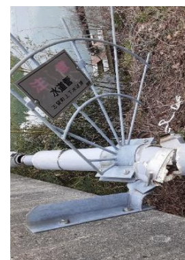
破損した上水管
