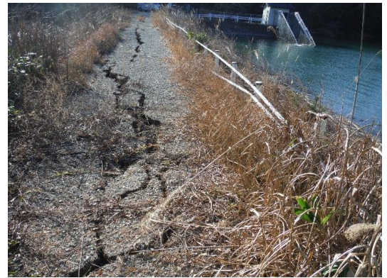
猪谷溜池の被災状況
