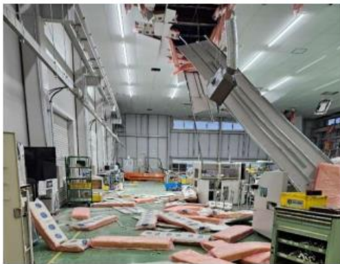
中核工業団地内工場の被災状況
