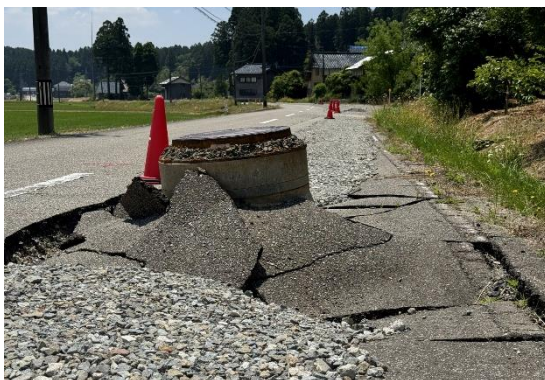
隆起したマンホール
