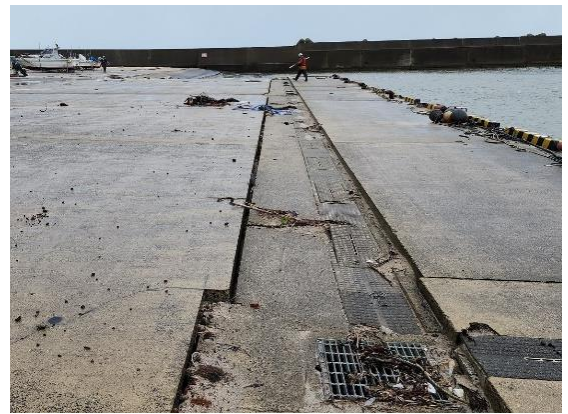
領家漁港の被災状況
