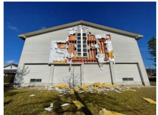
中核工業団地内の若葉台体育館の被災状況
