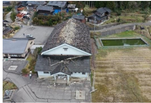
稗造交流センターの被災状況
