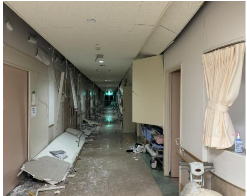
富来病院の被災状況
