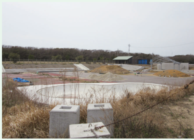
工事が中止されたままの アーバンスポーツ施設
