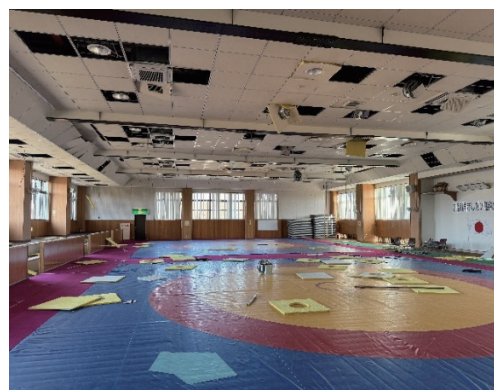
総合武道館2階の被災状況
