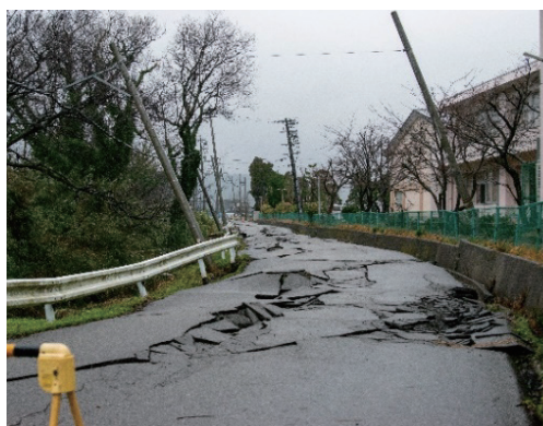
富来小学校付近の町道の被災状況
